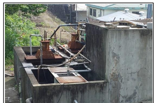
養豚業で用いられている汚水処理施設(浄化槽)
