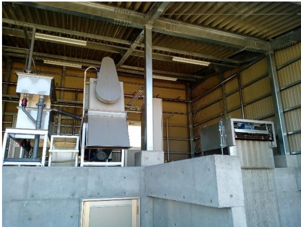
図3:汚水処理施設(汚泥搾水機)
